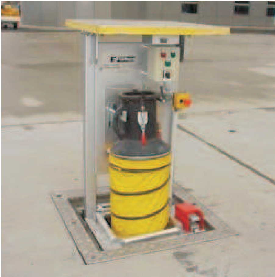
Fladung Underflor Solution 400 Hz 2 x 90kVA, 4 x 90kVA + PCA
